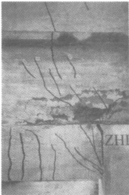
图 13 ZHL-1 右端破坏时裂缝情况及破坏形态
